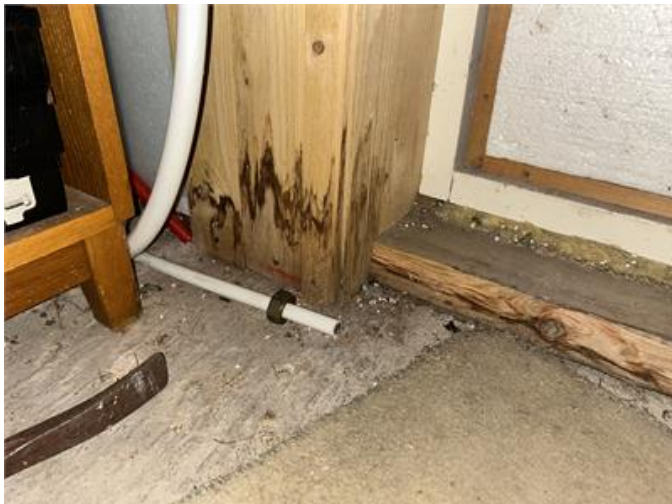
Källare: Fukktanvisning på panel i källare.
