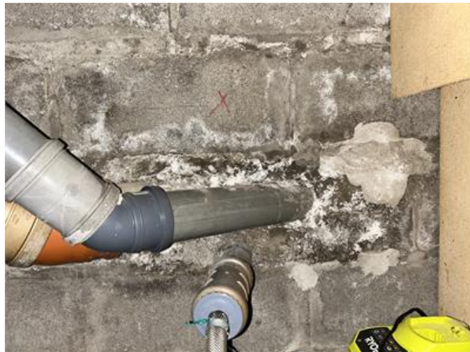
Källare: salt/kalk utfällning på grundmuren noteras.
