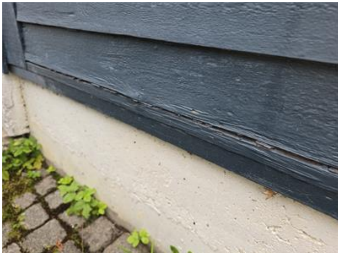
Exempel på panel med rötskador.
