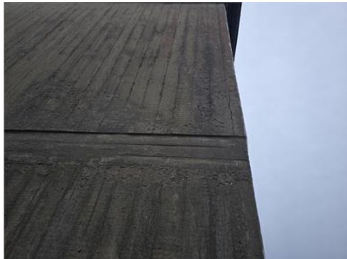
Exempel på spricka i betongfasad.
