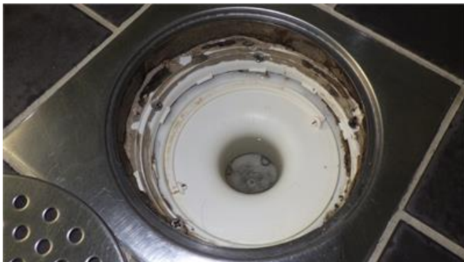
Golvbrunn utan synlig brunnsmanschett
