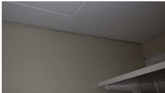
Spricka i tak/väggvinkeln
