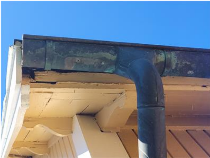
Rötskada i takfot
