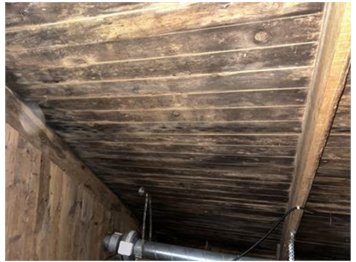
Nockvind: Mikrobiell påväxt på stora delar av underlagstaket.
