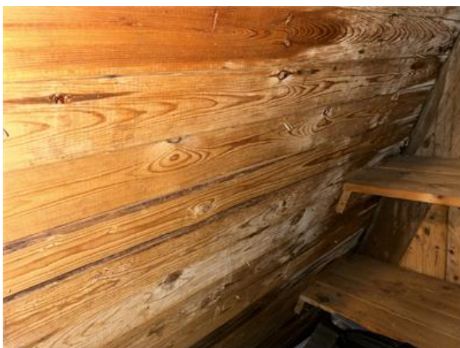
Sidovind Norr: Fukktanvisning samt mikrobiell påväxt.
