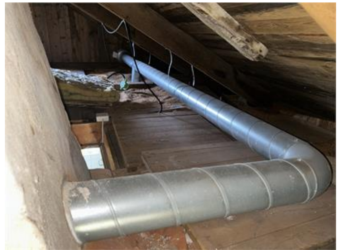
Nockvind: Oisolerade rör noteras i utrymmet.
