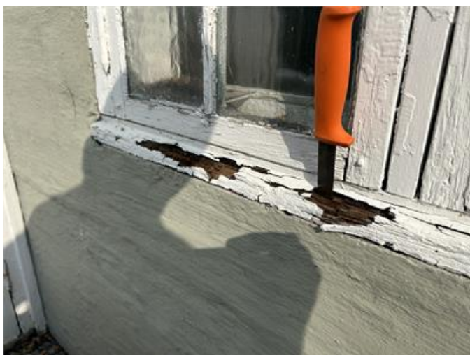
Fönster: Rötskada på fönster på bl.a. källarplan.
