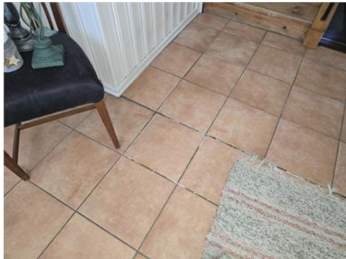
Spricka i golv, mellan tillbyggnad/befintlig del.
