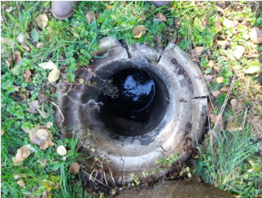
Bild 4 – Otätt betongrör (”fördelningsbrunn”)
