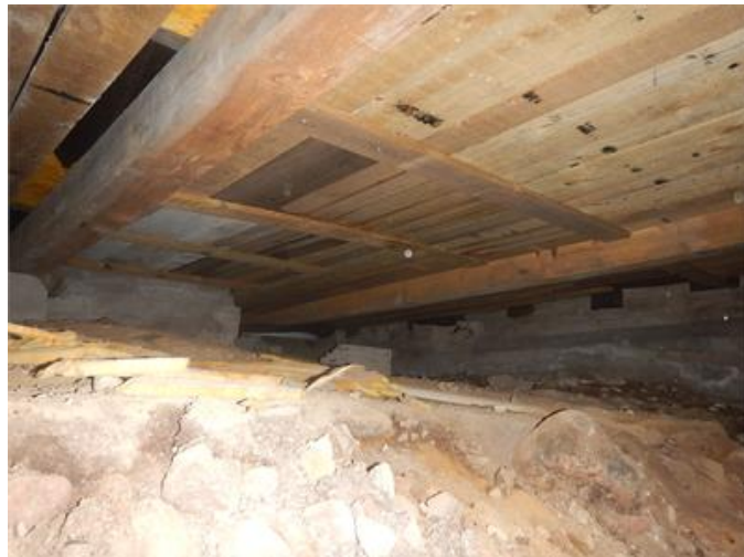
Mikrobiell påväxt på blindbotten i torpargrund.
