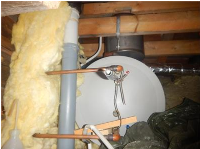
Varmvattenberedare olämpligt installerad på vind.
