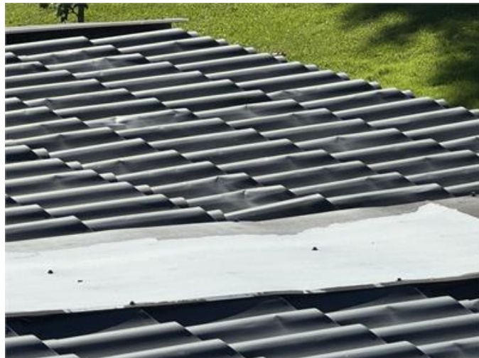
Tryckskador på plåttaket.
