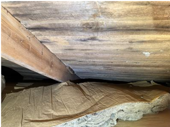
Fuktfläckar/mikrobiell påväxt på vindens underlagstak.
