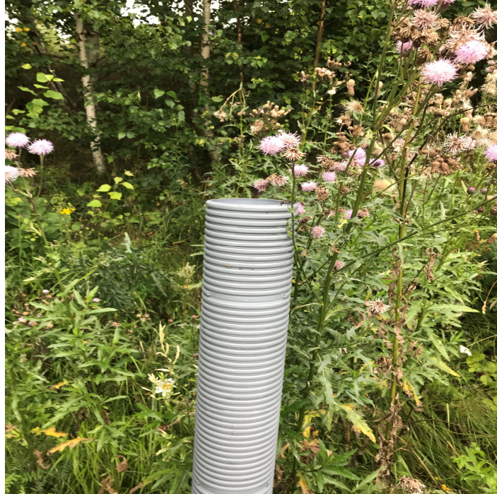
Ett av fyra luftningsrör saknade lock
