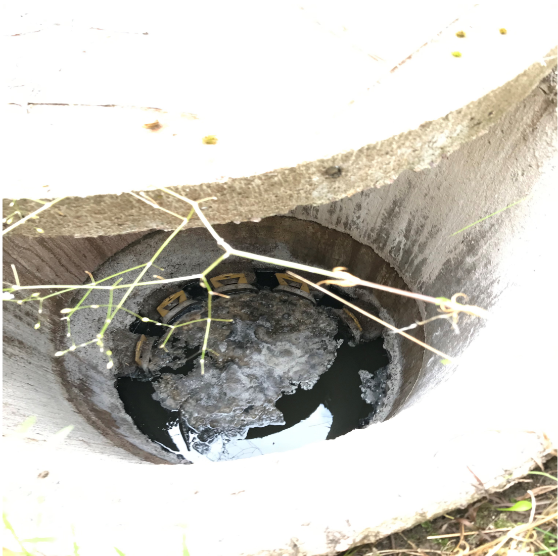
Fördelningsbrunn dit avloppsvattnet från samtliga fyra fastigheter går efter trekammarbrunnarna.
