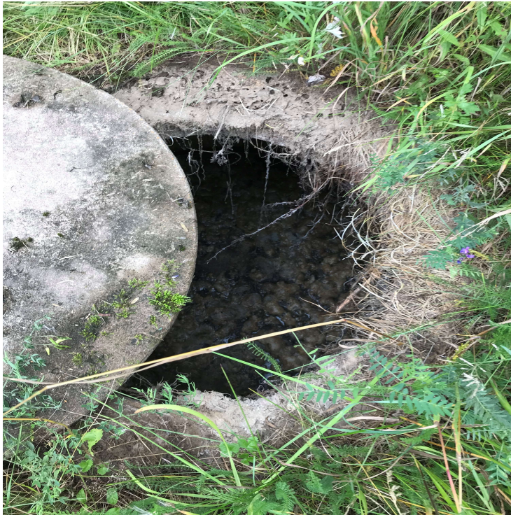
Brunn utan kamrar för avloppsvatten från Tuna 1:31 & Tuna 1:32. I dagsläget är inte Tuna 1:31 bebyggt så tillförsel av avloppsvatten kommer endast från Tuna 1:32.
