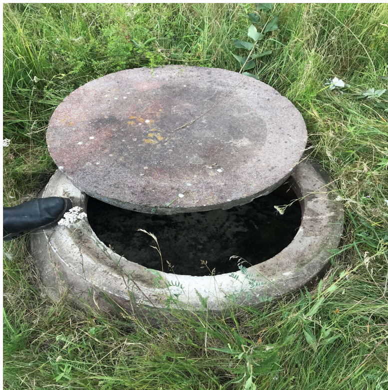
Brunn utan kamrar för avloppsvatten från Tuna 1:29 & Tuna 1:30
