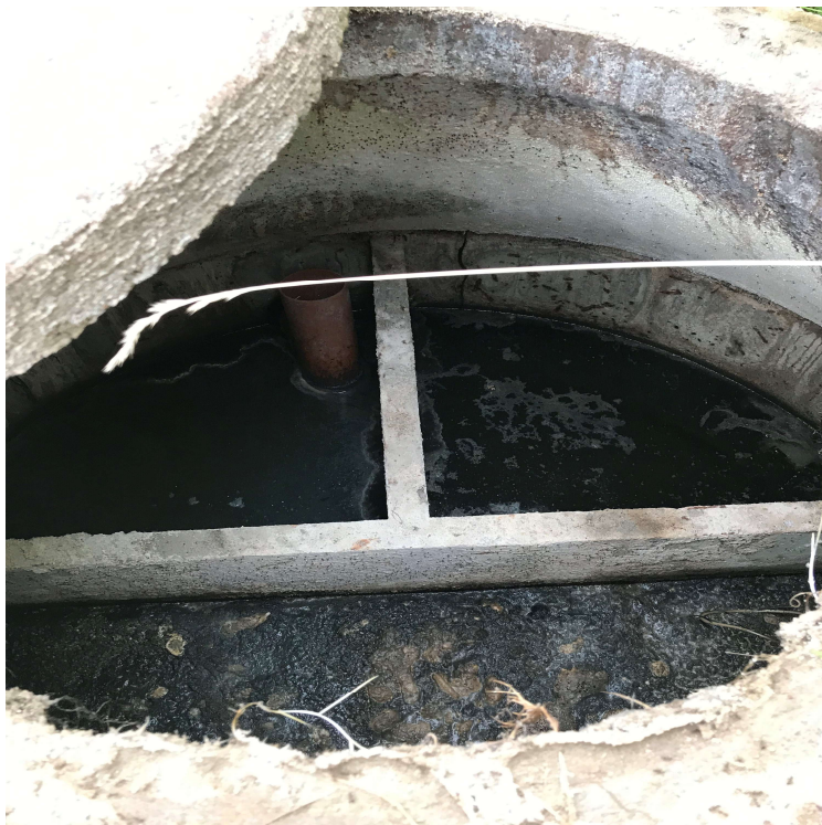
Trekammarbrunn för avloppsvatten från Tuna 1:31 & Tuna 1:32
