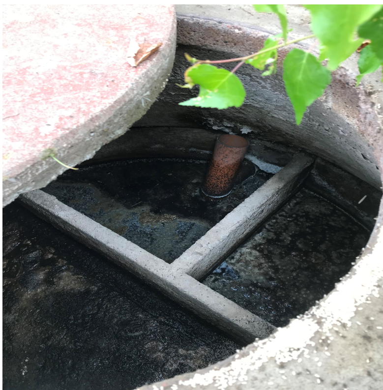
Trekammarbrunn för avloppsvatten från Tuna 1:29 & Tuna 1:30
