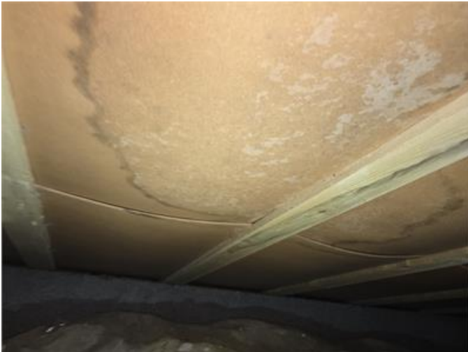
Fuktfläck på blindbottenskivor i Krypgrund under badrum.
