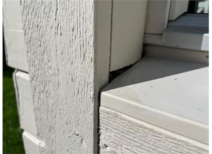
Bilden visar exempel på otätheter/brister vid/med plåtdetalj.
