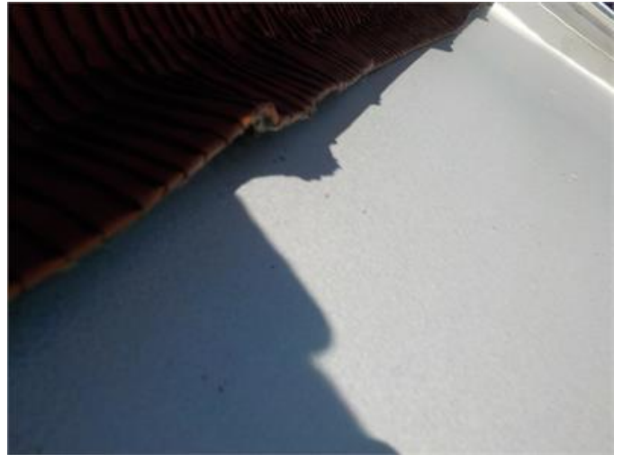
Nockband ansluter/tätar bristfälligt ner mot takplåt.
