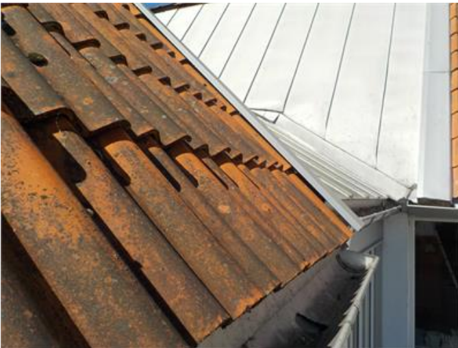
Vindskiveplåt ansluter bristfälligt ner mot tegelpannor.
