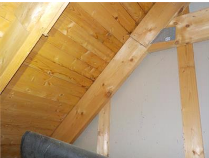
Vind tillbyggnad: Läckagemärken i underlagstak vid norra gaveln.
