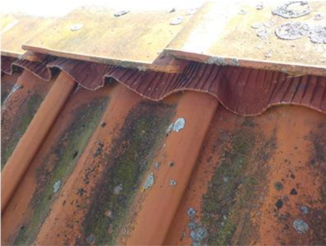
Nockbandet ansluter/tätar delvis bristfälligt mot tegelpannor.
