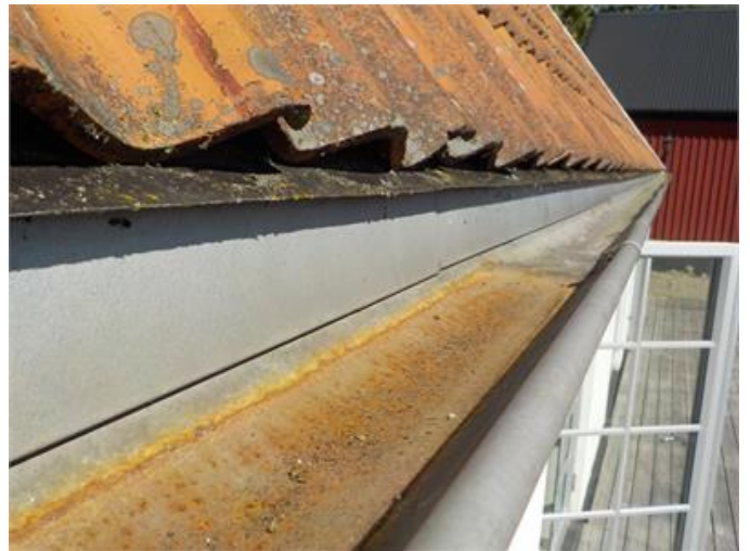
Rost i ränna och underlagspapp som sticker fram under tegelpannorna, brukar avslutas på fotplåten.
