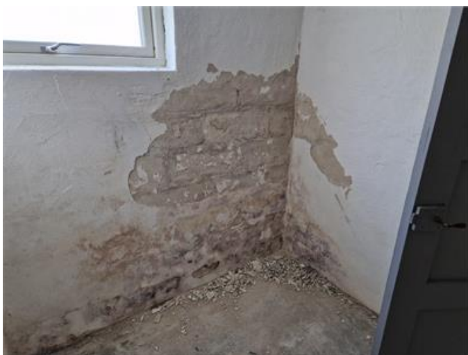
Källare: - Färg- och putssläpp förekommer på väggar och golv. - Renovering pågår - ej färdigställt.
