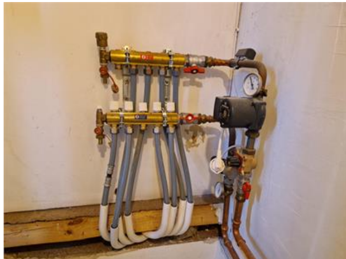
Källare: Fuktskydd saknas vid vatteninstallatoner.
