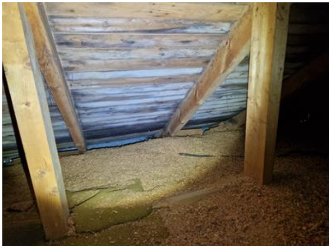
Vind: Mikrobiell påväxt förekommer i underlagstak.
