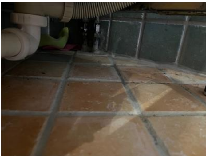
-Rör genomföringar förekommer i vägg bakom badkar på utsatt plats, vilket medför ökad risk för fuktskador.
