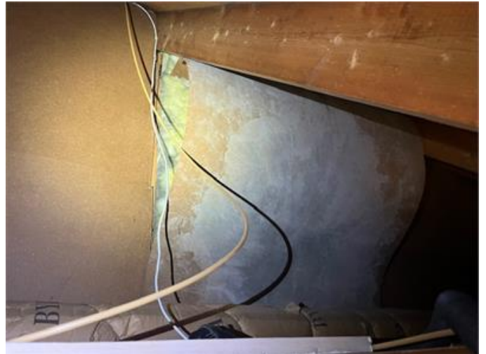
I sidvind har masonit skiva lossnat till isolering av vägg lossnat och behöver återmonteras
