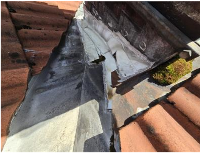
Tak: Bristfälliga plåtarbeten i rännadal samt mindre del trasiga pannor.
