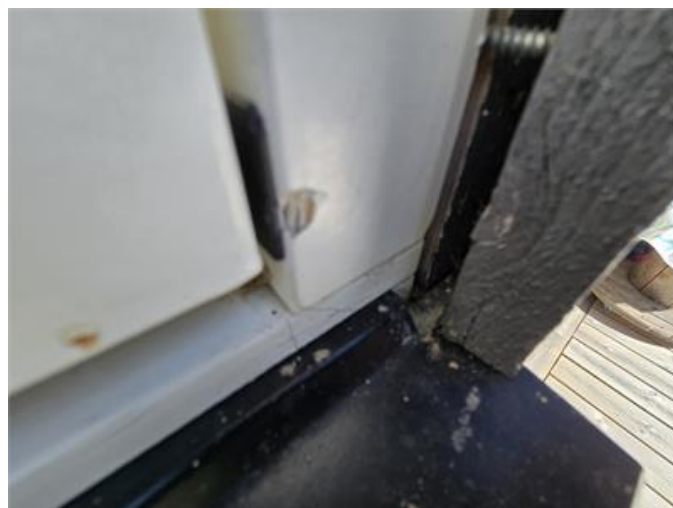
Fönster: Exempelbild på otätheter vid fönster.
