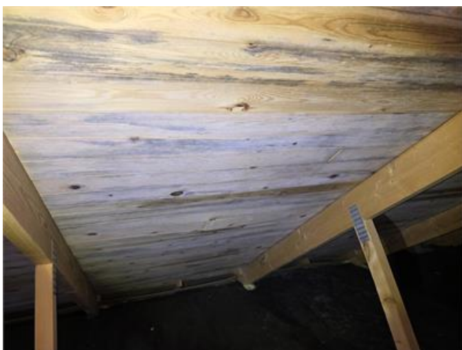
Nockvind: Mikrobiell påväxt på underlagstak.
