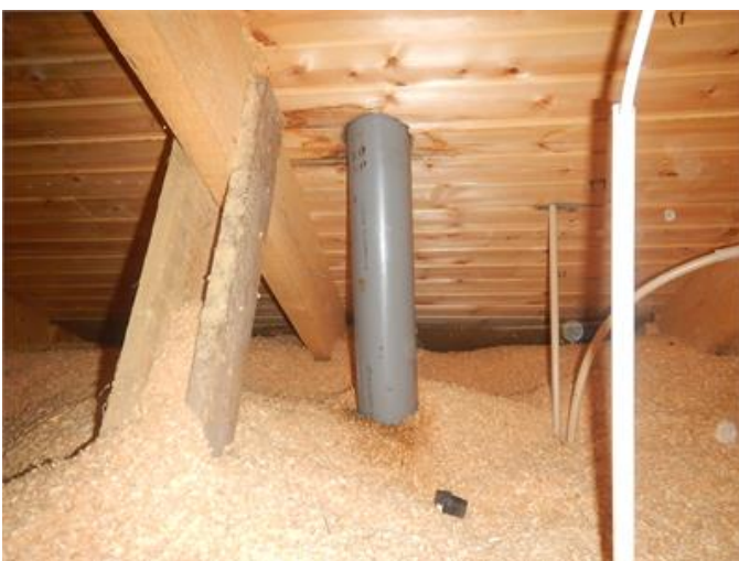
Exempel på fuktpåverkan på underlagstak vind.
