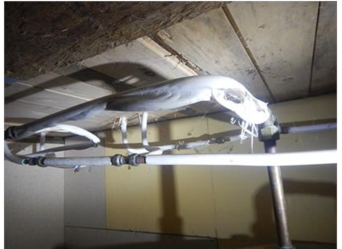
Tappvattenrör i matkällare värmepåverkade.
