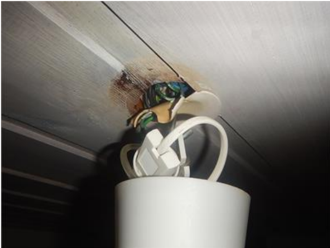
Kopplingsdosa på el med värmepåverkan.
