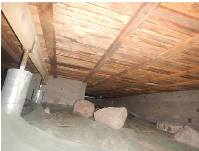
Mikrobiell påväxt på blindbotten i krypgrund.
