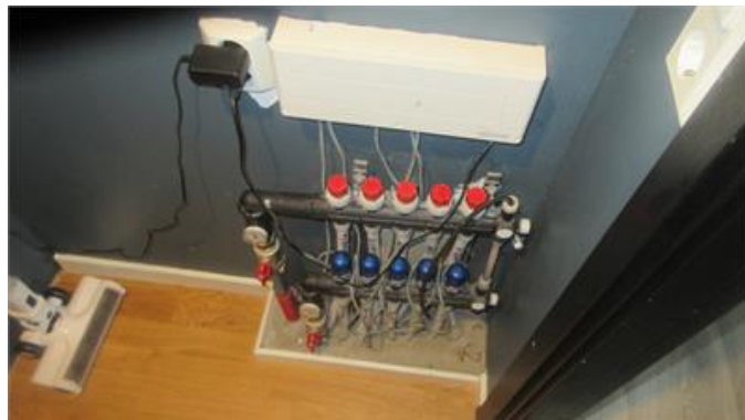
Exempel på ej fuktsäkert utförd vatteninstallation.
