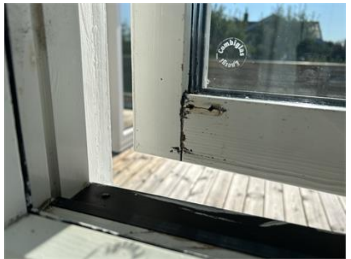
Fönster: Fukktanvisning på fönster i bl.a. sovrum 2, sannolikt kondens relaterat..
