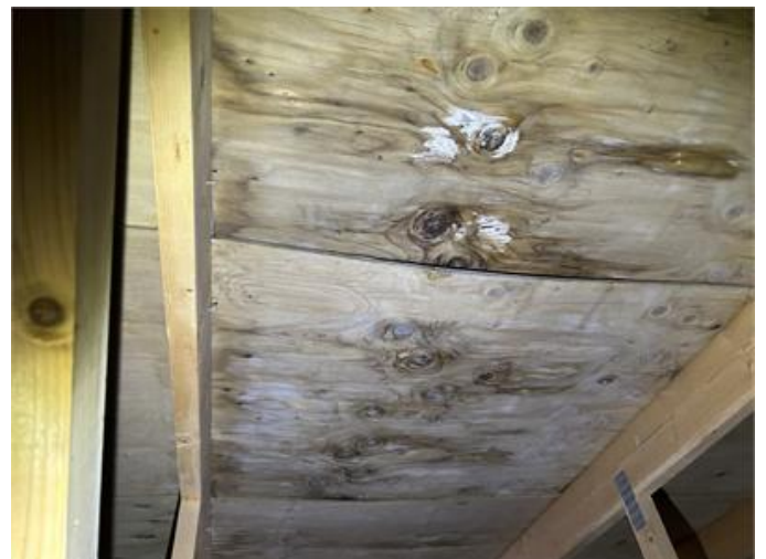
Garagenockvind: Underlagstaket har Fukktanvisning samt mikrobiell påväxt.
