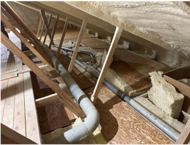
Nockvind: Oisolerade rör förekommer i utrymmet.
