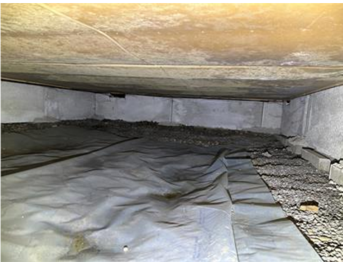
Krypgrund: Översiktsbild samt mikrobiell påväxt finns på blindbottenskivor.
