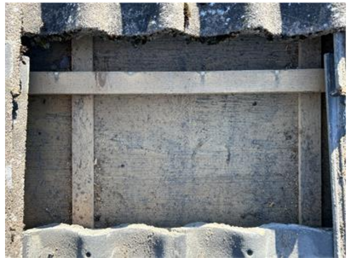
Tak: Underlagstaket har ingen täckning av underlagspapp.
