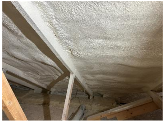
Nockvind: Oklart om det finns luftspalt mellan spray isolering och underlagstaket.
