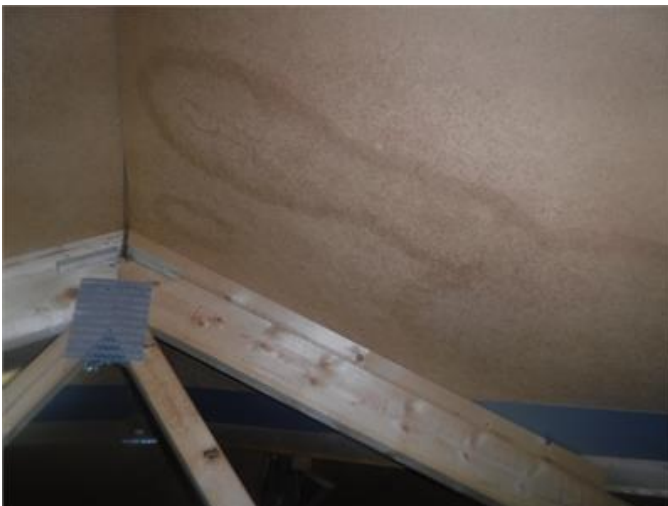
Vind/bostadshus: Det noterades spår av fuktrinrängningar på undertaket vid rörgenomföringar och under rännalsplåtar vilket kan anses vara normalt och kan ske vid viss väderlek.
