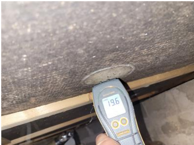
Fuktfläck på blindbotten
