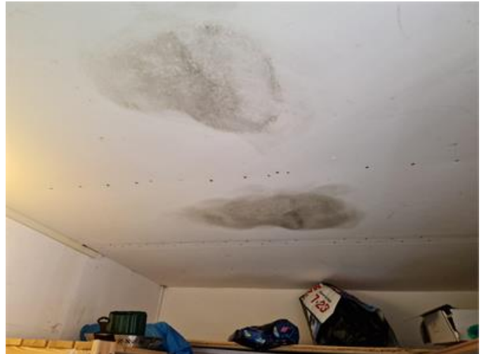
Garage: Fuktfläckar förekommer i innertak i förrådsdel.
