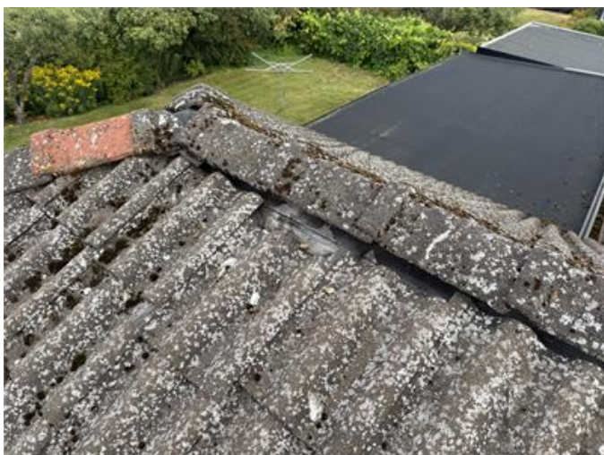
Takpannor ur position noterades. Underlagspappen är lokalt trasig.
