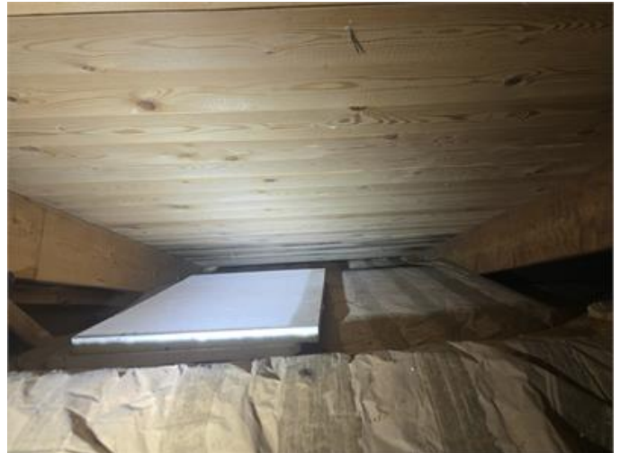
Exempelbild, mikrobiell påväxt underlagstak,nockvind.
