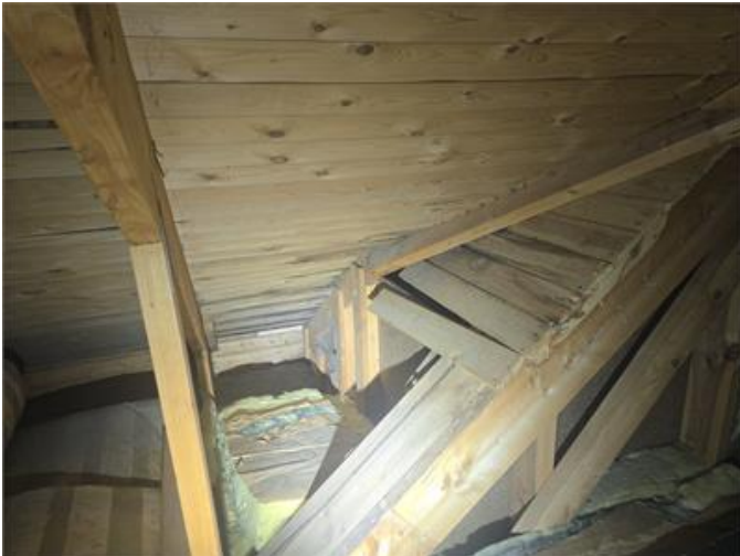
Exempelbild, fuktfläckar i underlagstak, vind med dörr från klädkammare.
