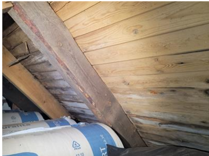
Mikrobiell påväxt på underlagstak
