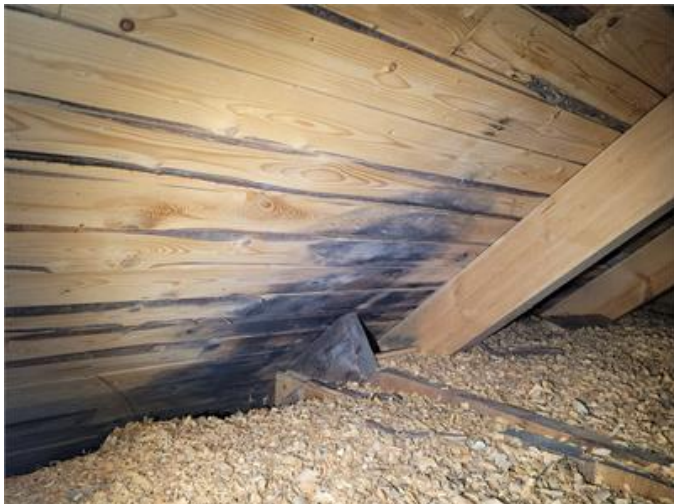
Mikrobiell påväxt på underlagstak
