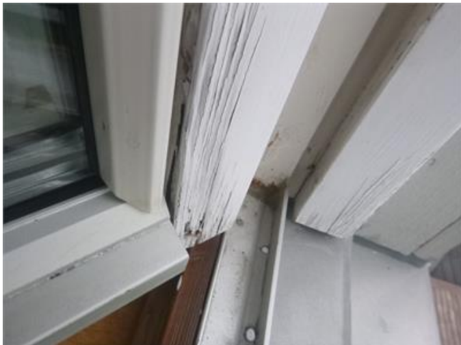
Bilden visar exempel på rötskador i dörr.
