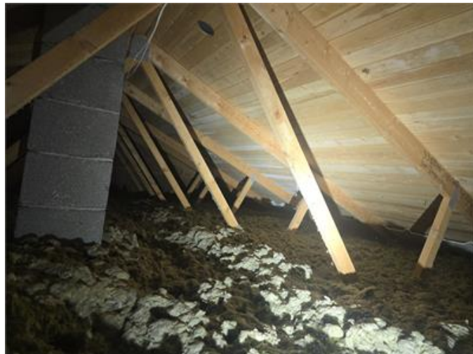
Exempelbild, mikrobiell påväxt underlagstak, vind.
