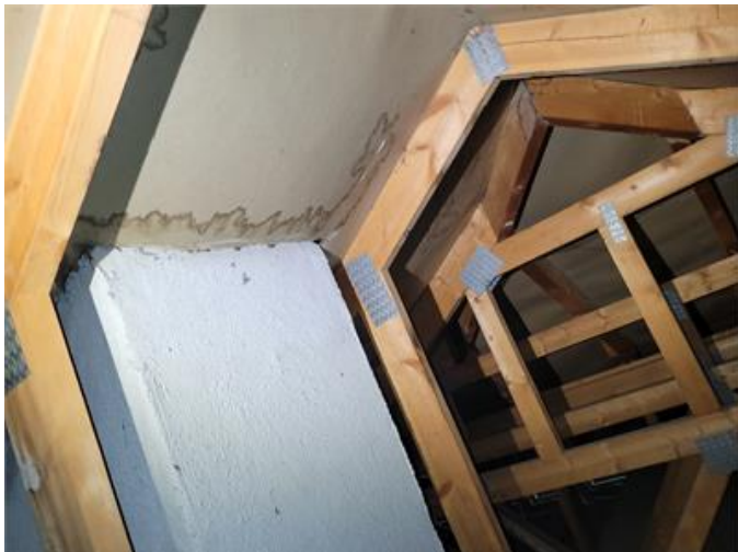
Fuktfläckar på underlagstak
