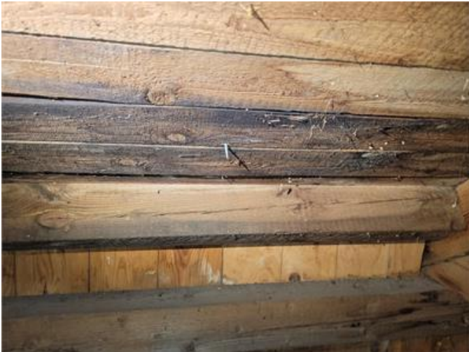
Fuktfläck på underlagstak
