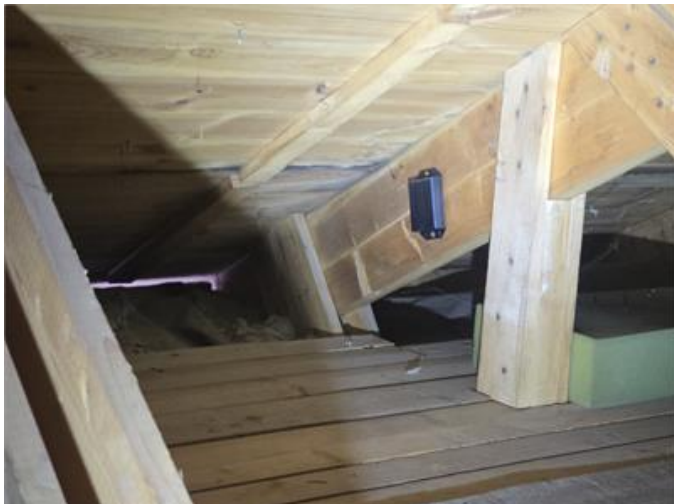
Exempelbild, fuktfläckar underlagstak, sidovind.
