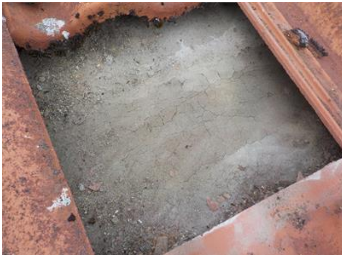
Ytliga torrsprickor förekommer i original underlagspapp.
