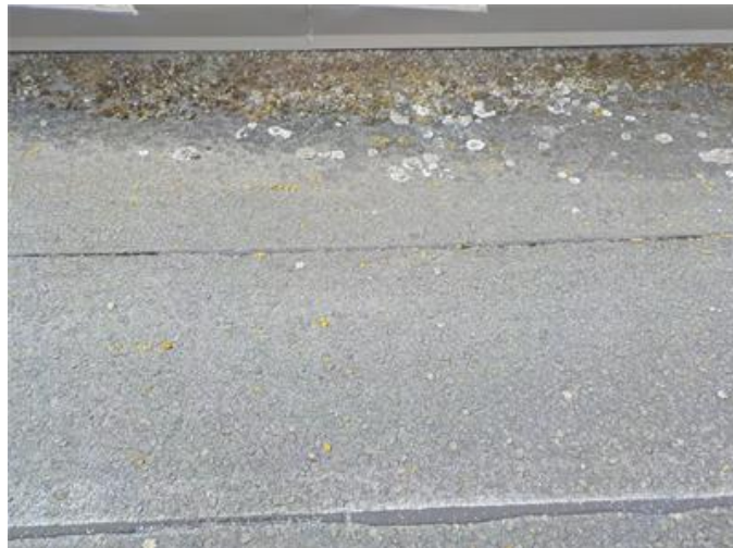
Ytliga torrsprickor förekommer i pappen och påväxt av bl.a. lav och mossa.
