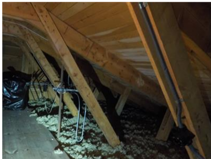
Mikrobiell tillväxt på delar av underlagstaket.
