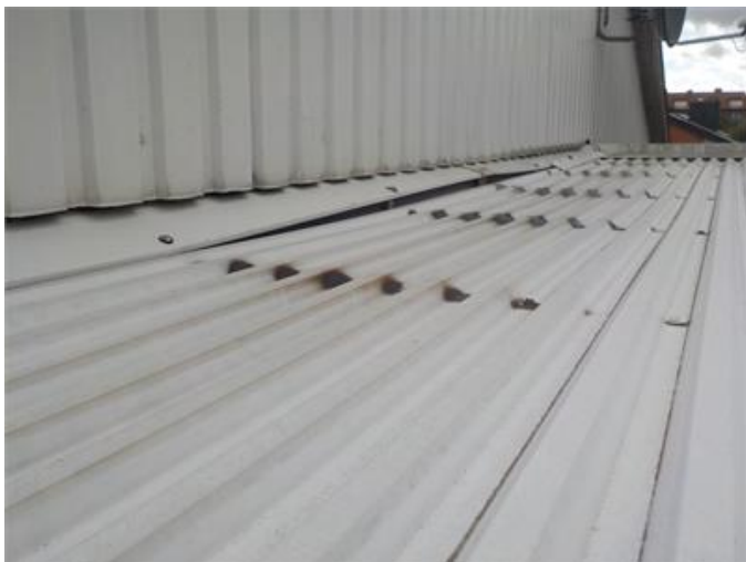
Bristfällig plåtning vid anslutning carportstak/fasad.
