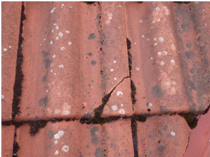
Sprucken takpanna samt påväxt av mossor.
