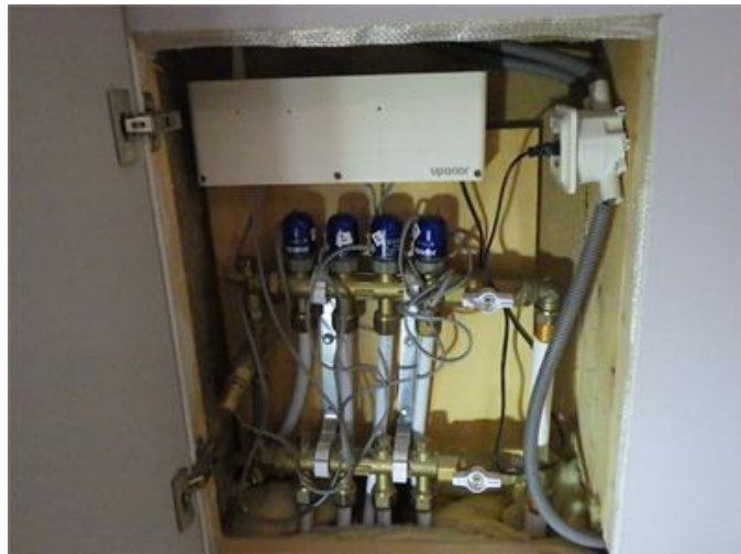
Ej fuktsäkert installerad golvvärmefördelning (övre plan).
