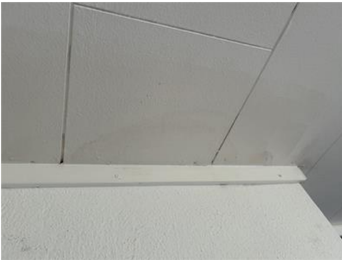
Vardagsrum: Fuktanvisning i innertak, från gammalt läckage enligt uppgift.
