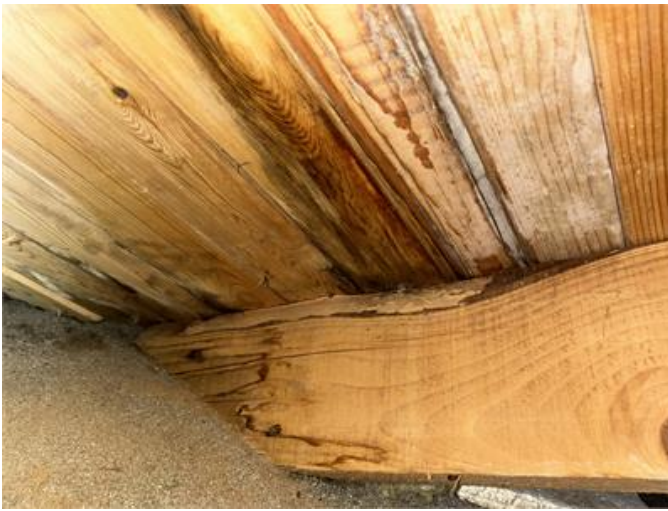
Nockvind vinkel: Fuktanvisning vid rännor, torr vid besiktning.
