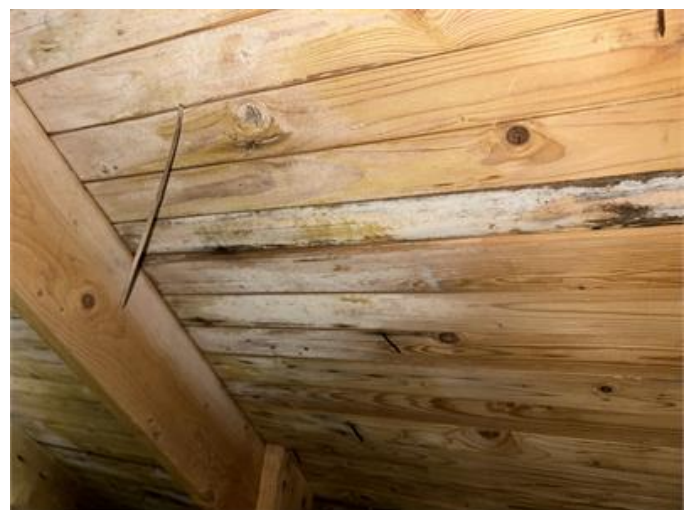
Nockvind: Mikrobiell påväxt på underlagstaket.
