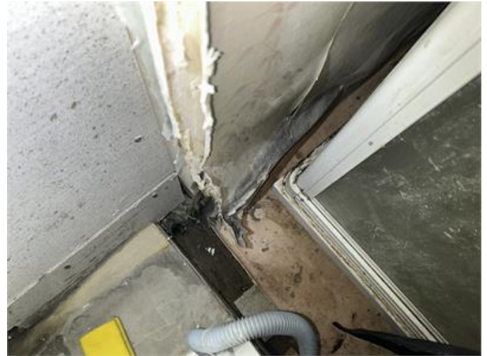
Källarplan: Våtrumstapet har släppt samt mikrobiell påväxt.
