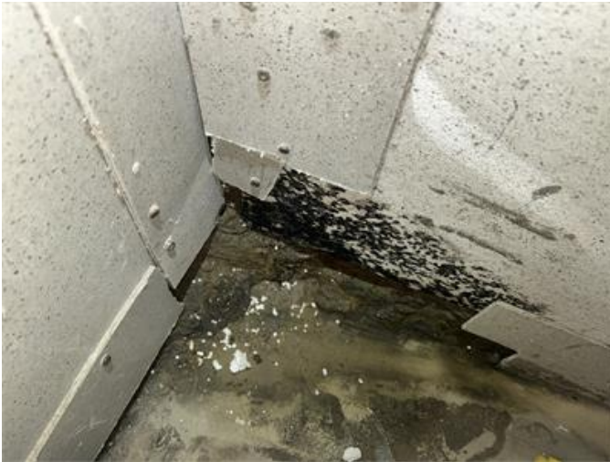
Källarplan: Mikrobiell påväxt på skivor vid bl.a. tvättmaskin samt synligt berg.
