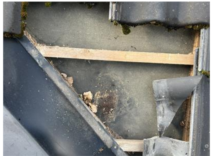
Tak: Kontroll vid rännor med anmärkning skräp/löv.
