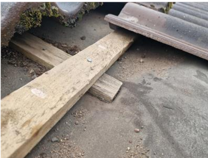
Tak, vid takfoten har ströläkten skavt hål i underlagspappen.
