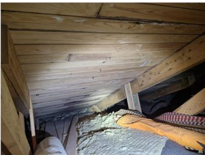
Nockvind, torra läckagefläckar samt mörk mikrobiell påväxt ner mot takfoten.
