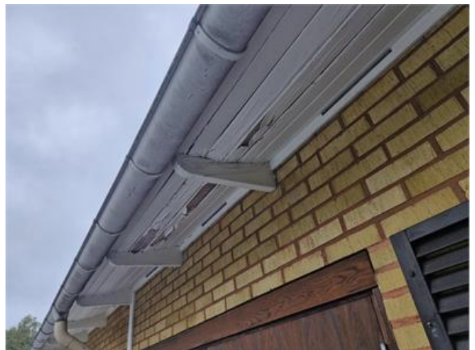
Tak, färgsläpp takfot ovan garageport, misstankar om läckage.
