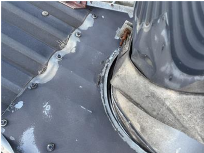
Plåtstos runt skorsten har spruckit.
