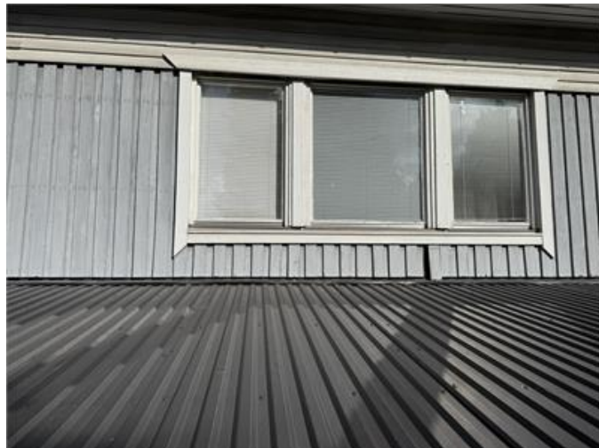
Fasaden ovanför uterum har underhållsbehov.
