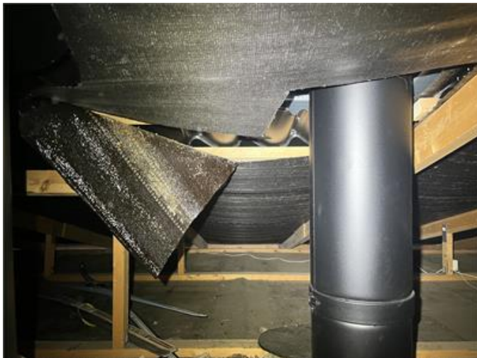
Bilden visar vinden där takduk under takplåt ej sluter tätt.
