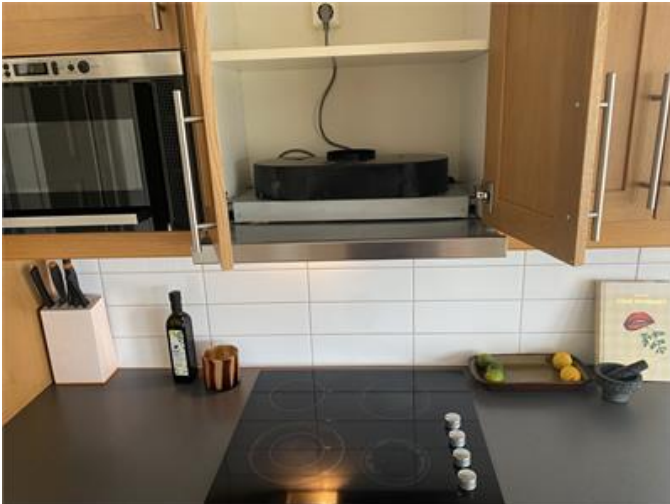
Fläkt i köksskåp
