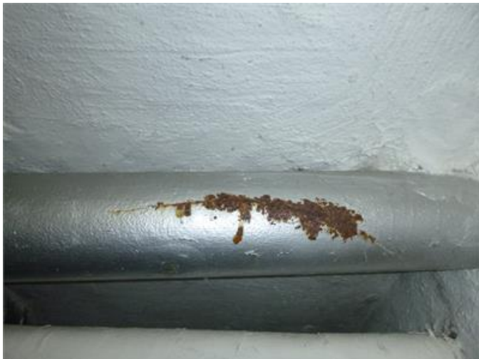
Korrosion i avloppsstam i källare
