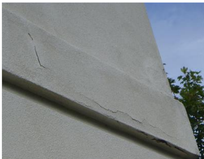
Sprickor i putsad fasad
