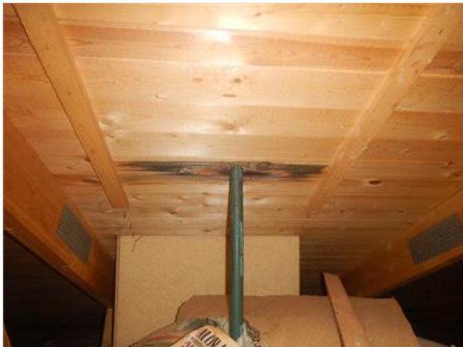
Fuktfläck runt expansionsrör vind.
