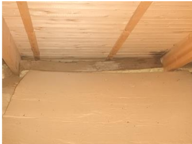
Exempel på mikrobiell påväxt på vind.
