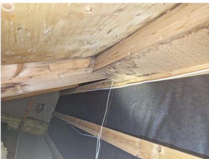
Sidovind söder, torra fuktanvisningar under halvmåne fönster.
