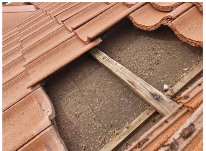
Tak, papp och läkt med normalt ålderslitage.
