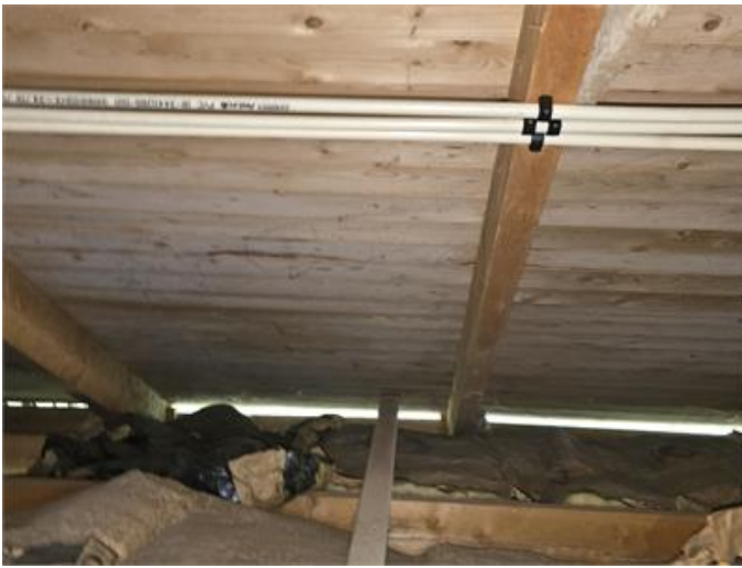
Nockvind: Ytlig vitaktig mikrobiell påväxt på underlagstak.
