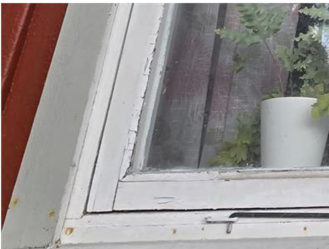
Fönster: Exempelbild på fönster med underhållsbehov.
