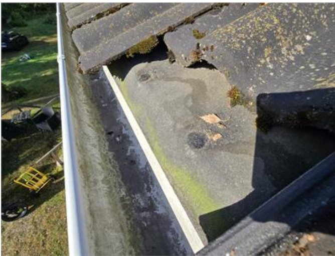
Tak: Pannor ligger direkt på underlagspapp, risk för skador i takfot.
