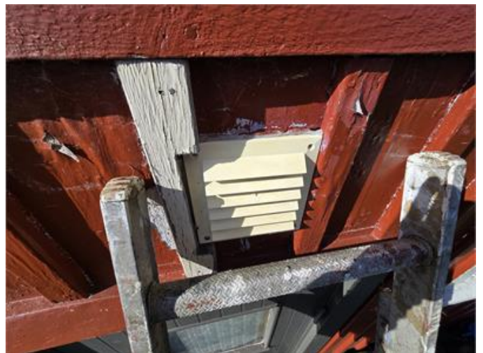
Fasad: Otätheter samt underhållsbehov noteras.
