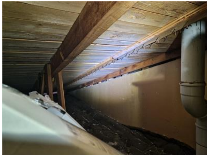
Lokala fukt/mikrobiella påväxter på vindsutrymmet
