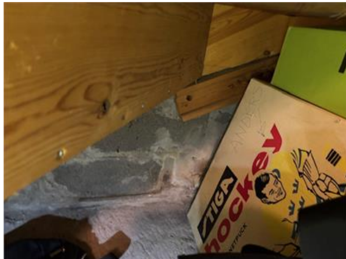
Kalk/salt utfällningar i förråd under trappa.
