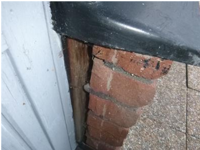
Bilden visar exempel på otätheter/brister i fasaden.
