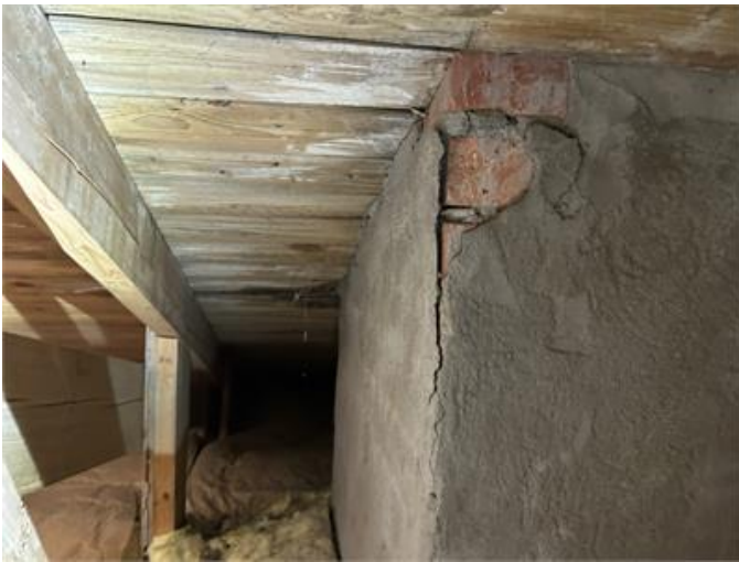
Nockvind: Fuktanvisning vid bl.a. murstocken samt putssläpp.
