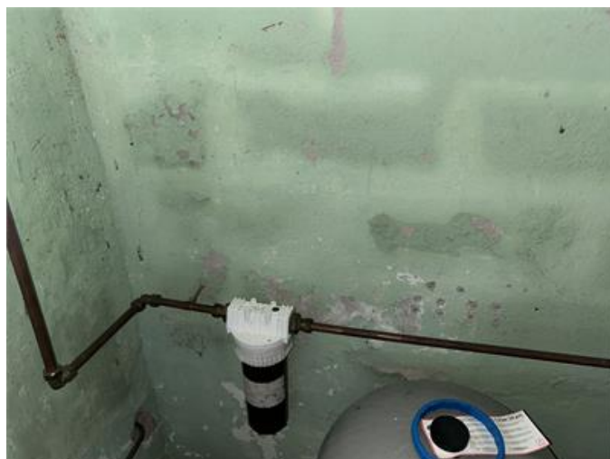
Källare: Fuktgenomslag samt mineralutfällning på flera ställen.
