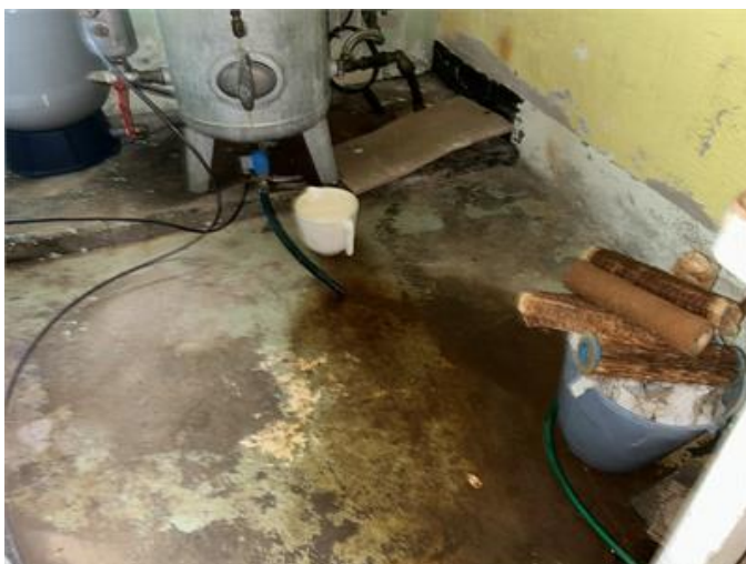
Källare: Fuktig miljö samt stående vatten sannolikt från ackumulatortank.
