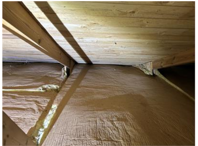
Nockvind: ingen takfotsventilation på flera ställen.
