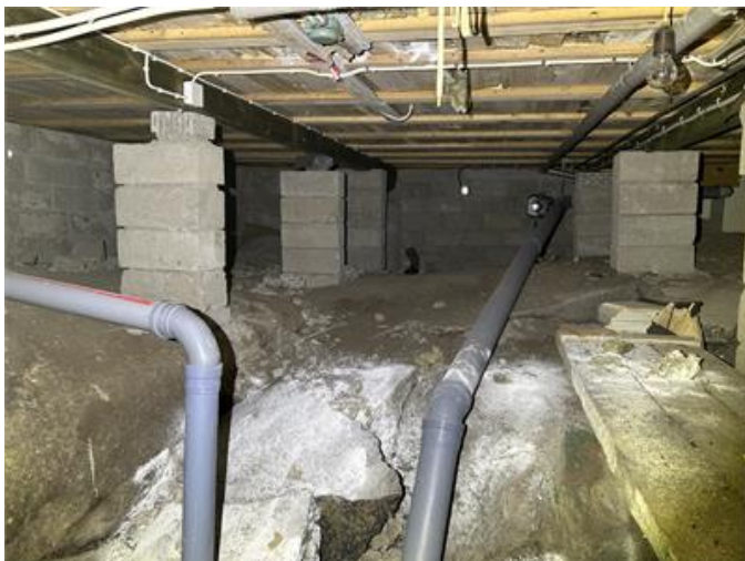
Krypgrund: Översiktsbild samt rikligt med råttgift.
