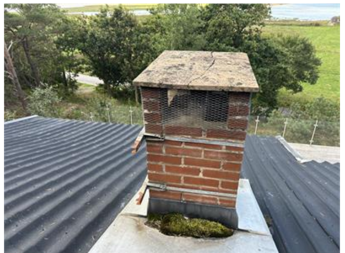
Tak: Väderskydd har spricka.
