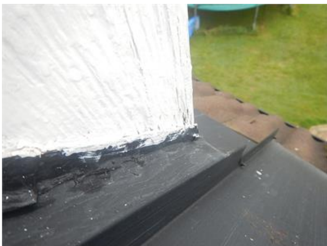
Mindre rötskada i pelare på balkong mot takstege.
