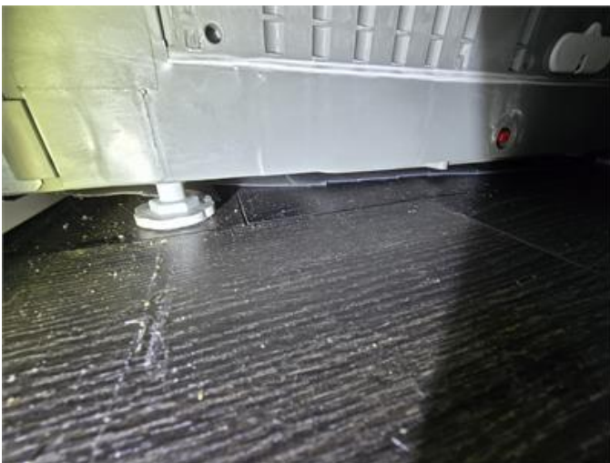
Kök: Fuktskydd under diskmaskin avskuret.
