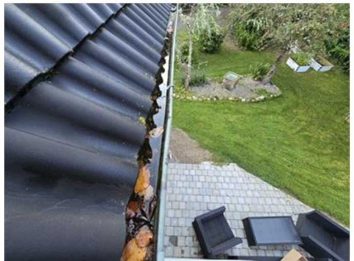
Stuprör/rännor: Stående vatten, justeringsbehov.
