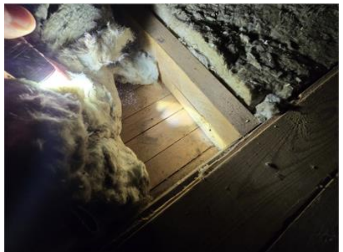
Nockvind: Fuktspärr finns ej under isolering.
