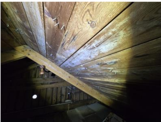
Nockvind: Mikrobiell påväxt/missfärgningar på underlagstak.
