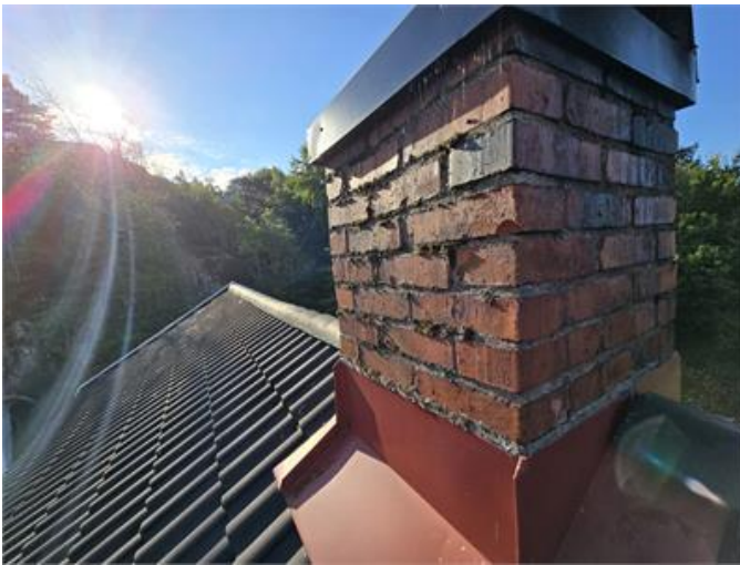
Tak: Mossa samt fogsläpp på murstock.
