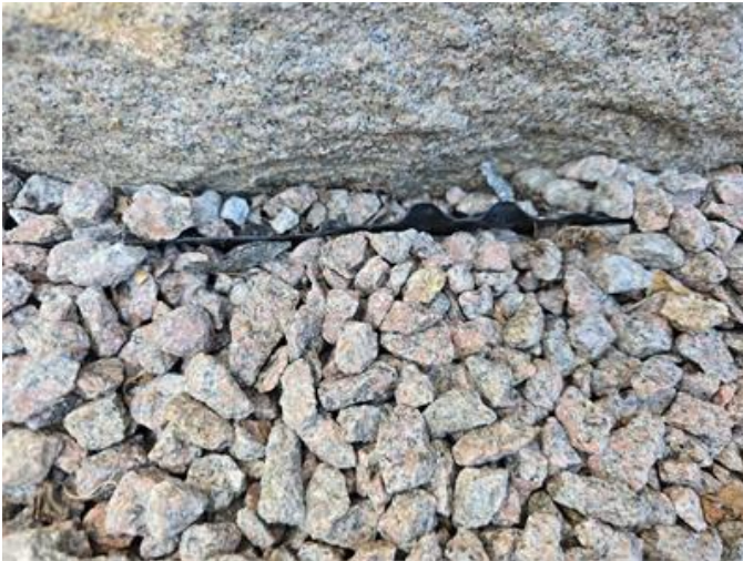
Sockel: Fuktskydd utan list.
