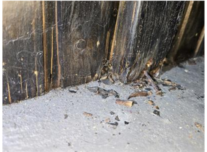
Bastu: Rötskadade träkonstruktioner i bastu.
