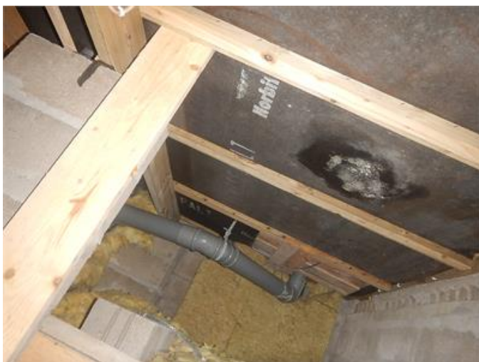
Fuktfläck under dusch/wc.
