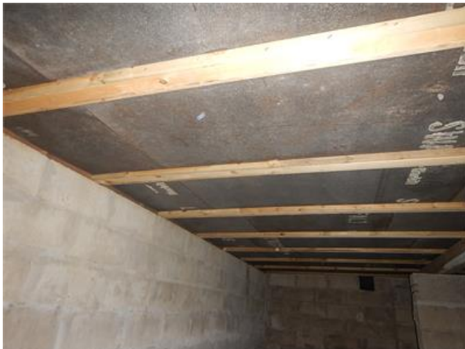
Mikrobiell påväxt på blindbotten.
