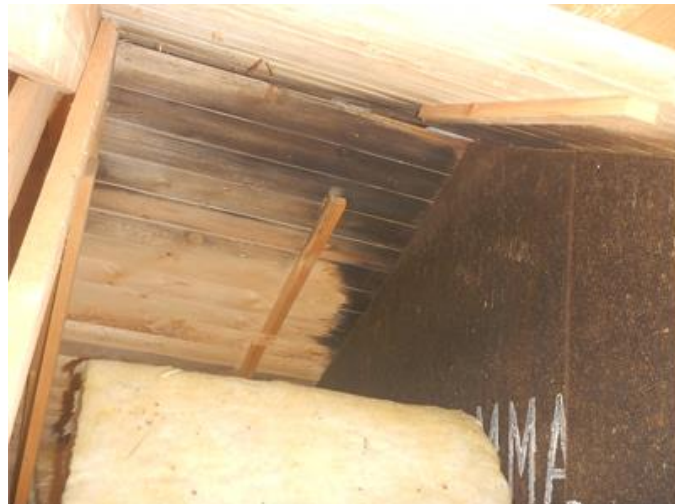
Mikrobiell påväxt på underlagstak vind.
