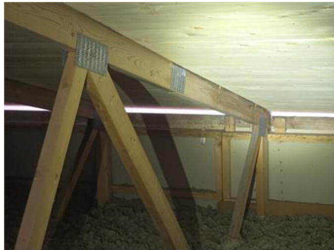
Exempel på missfärgning på takstol.
