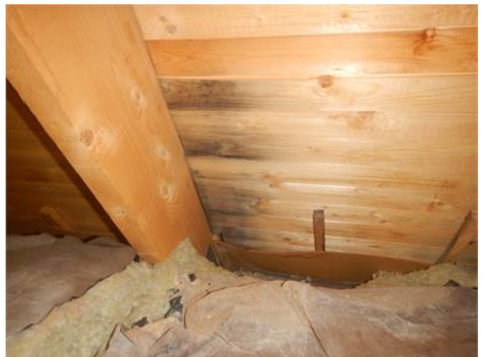
Mikrobiell påväxt på underlagstak.
