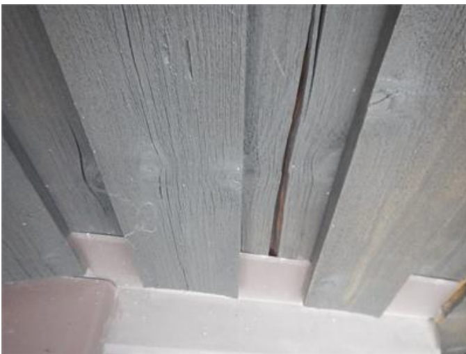
Exempel på sprucken panel.
