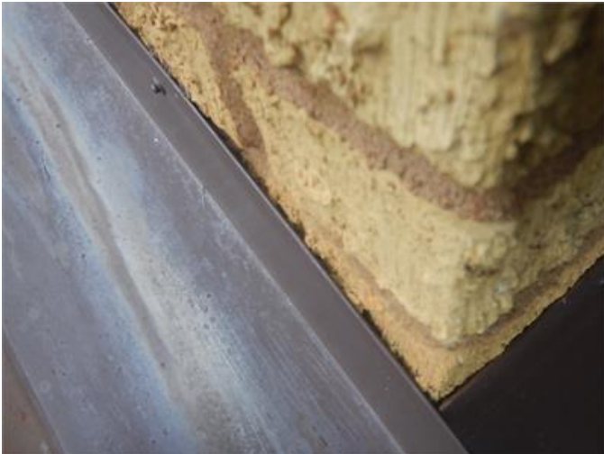
Otätthet mellan murstock och skorstensbeslag.
